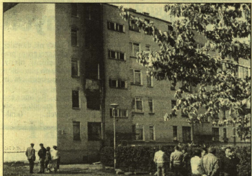
Wypalone okna na pierwszym piętrze.
